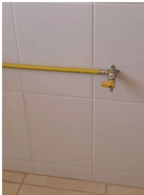
Figura 30 - Tubulação de Abastecimento de Gás
