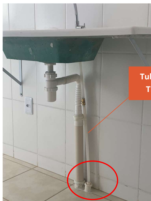
Figura 26 – Tubulação de Esgoto e tubulação de água Tipo PEX
