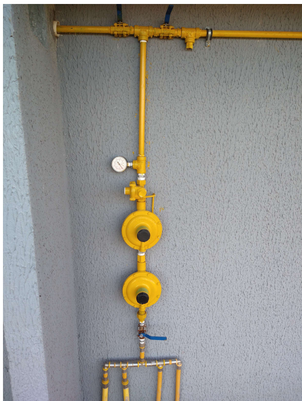
Figura 29 – Registro de gás por bloco
