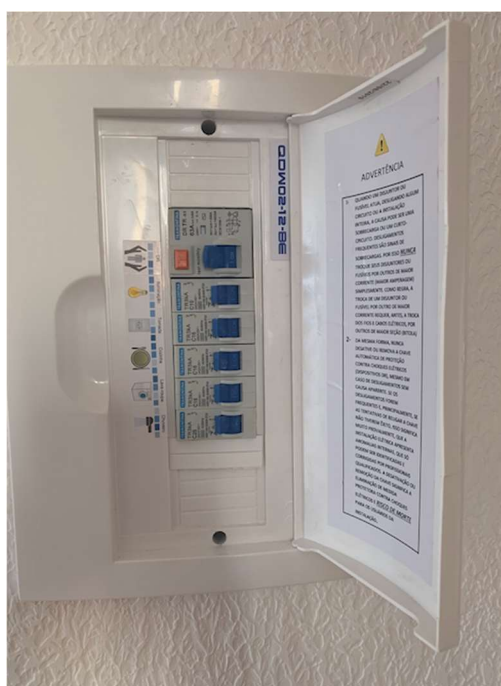
Figura 20 - Quadro de Distribuição de Luz do apartamento (QL)
