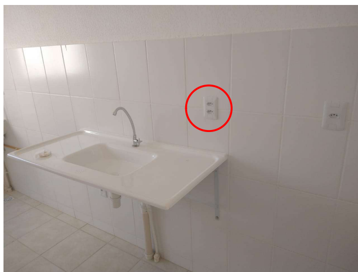
Figura 21 – Tomadas de 20 A instalada na cozinha (em destaque)
