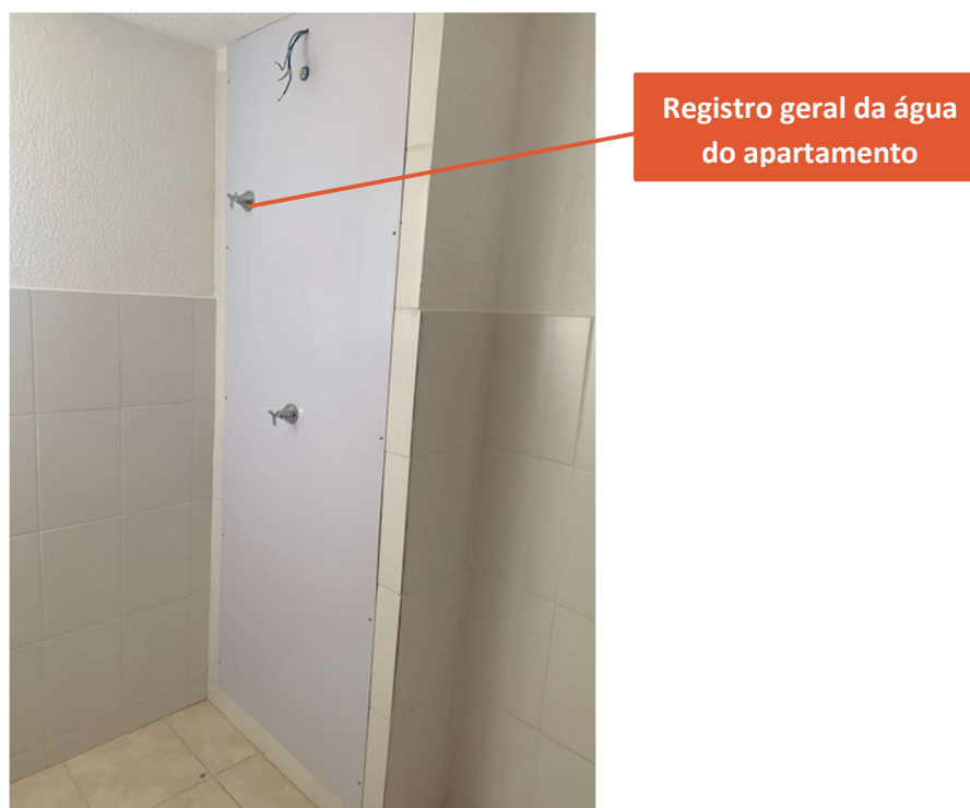
Figura 24 – Shaft instalado no banheiro
