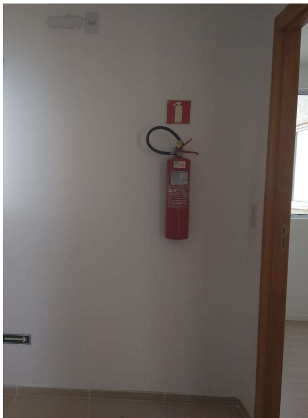
Figura 31 - Extintor de incêndio
