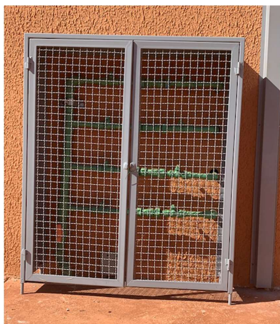
Figura 23 - Cavalete para previsão da instalação do hidrômetro
